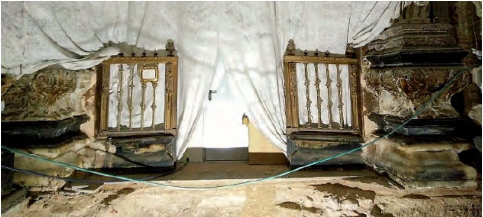
Fig. 8. Detalle de deformación y desnivelado de la reja de la capilla de San José.
