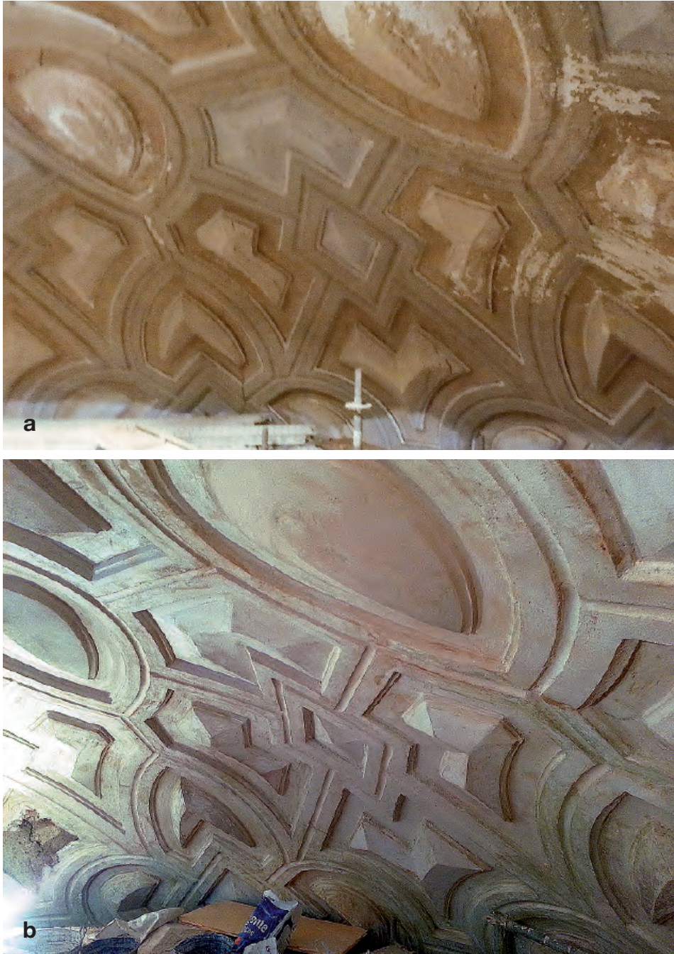
Fig. 20. Detalle de los yesos cortados del casco de la cúpula en su estado inicial y una vez eliminado el repinte de 1864, mostrando el efecto plástico original. Fotografías tomadas durante las obras, en 2016.
