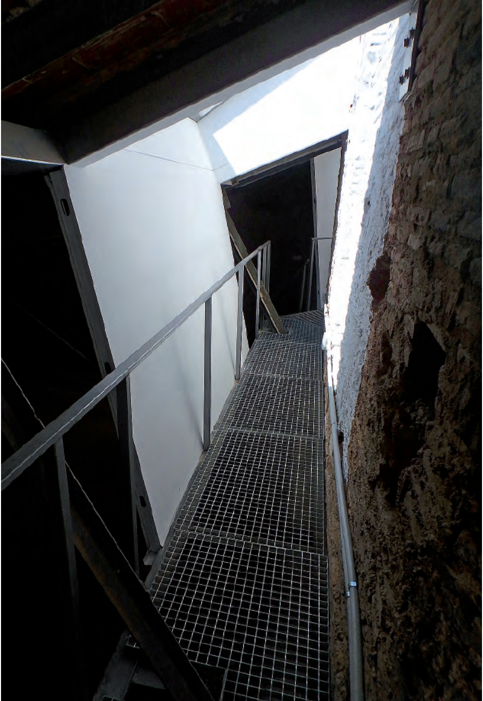
Fig. 14. Caja de reflexión en la cúpula, situada entre un lucernario y el ventanal del tambor, sobre la pasarela de mantenimiento.
