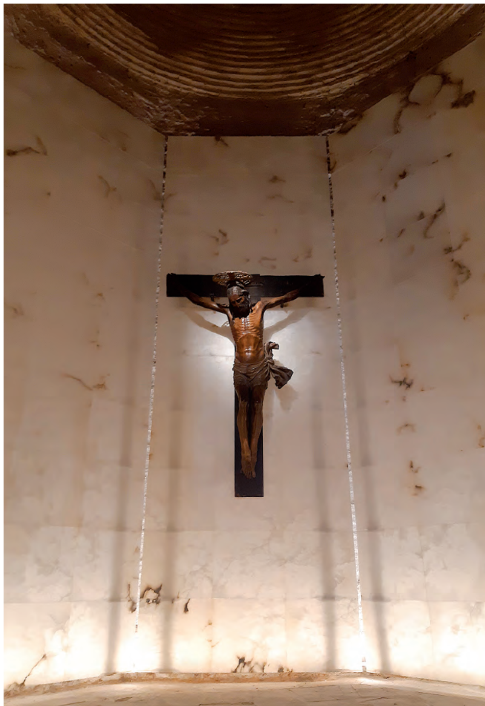
Fig. 9. Interior actual de la capilla del Santo Cristo, con los lienzos traslúcidos de alabastro, despegados de los muros.
