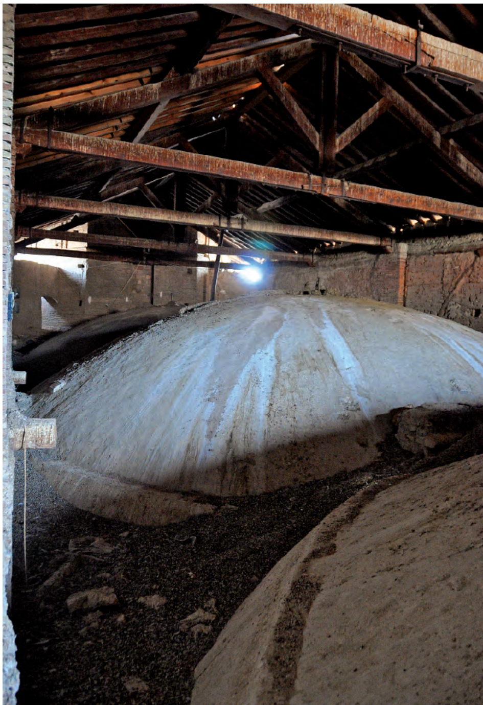
Fig. 35. Detalle del trasdós de las bóvedas que cubren la nave central, mostrando las riñoneras aparejadas a rosca, y los cierres, con técnica tabicada.
