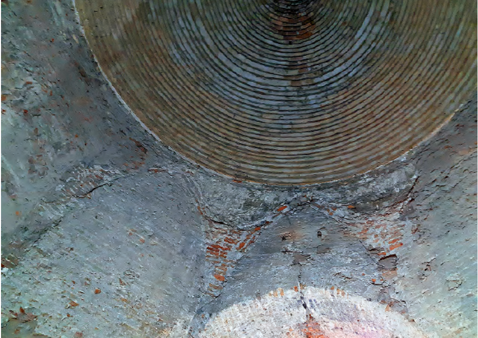
Fig. 22. Vestigios, recuperados en 2022, de la bóveda octopartita que cubría la capilla del Santo Cristo y fue demolida en 1972. Se aprecian las improntas de la plementería, tabicada de dos hojas, y los enjarjes, que se solidarizaron con la superpuesta falsa bóveda en saledizo.
