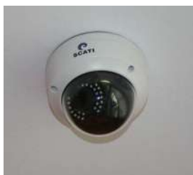
Sistema de vigilancia
